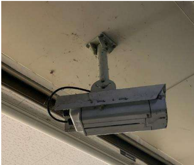
カメラ (取付前)
